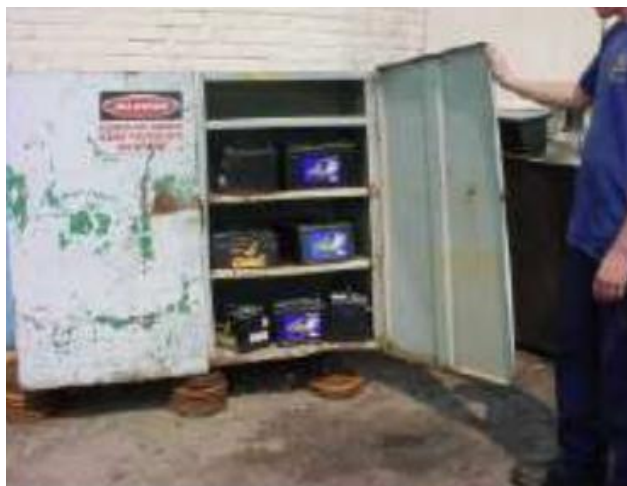
完整电池的临时存贮设施
