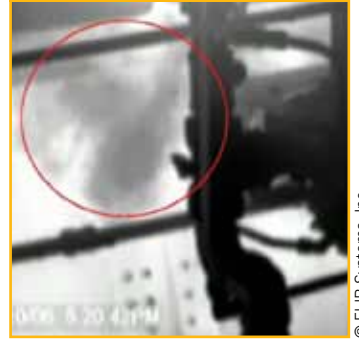
红外线摄像机拍摄到的泄漏阀门
