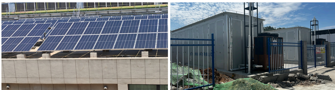
图3-2 A公司源网荷储一体化项目场景图
